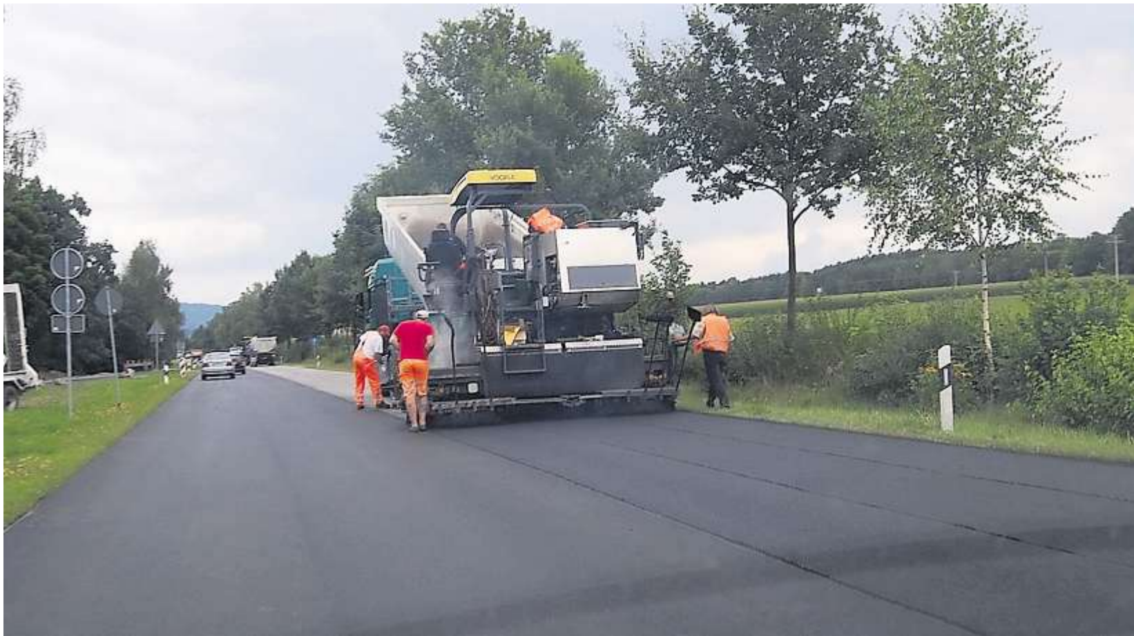
Auf der B 85 wurde eine neue Deckschicht aufgebracht. Dazu musste die Fahrbahn halbseitig gesperrt werden.
