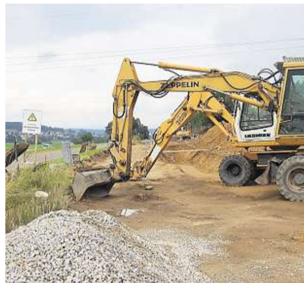
Im Bereich des Wirtschaftsweges neben der B 85 wird die neue Hauptwasserleitung verlegt.
