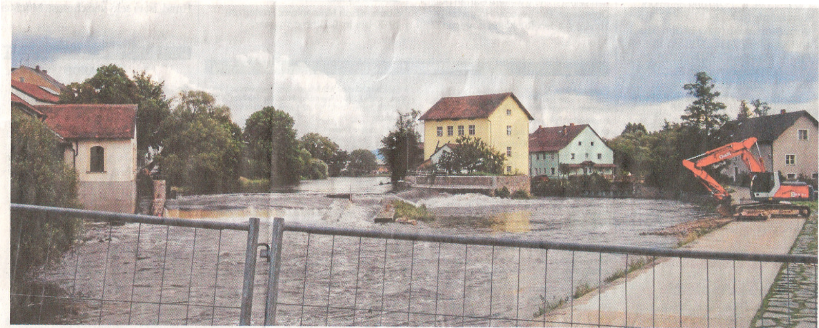
Montagabend, 18.30 Uhr: Die Baustelle ist komplett untergegangen, die Deiche sind weg, nur noch ein paar Eisenteile schauen aus dem Wasser.
