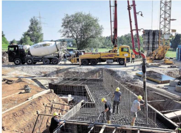
Seit Freitagmorgen rollen hier die Betonmischer an: Auf der Baustelle der Westumgehung Kümmerbruck bei Theuern werden gerade die Fundamente für die erste Brücke gesetzt. Bild: Stephan Huber
