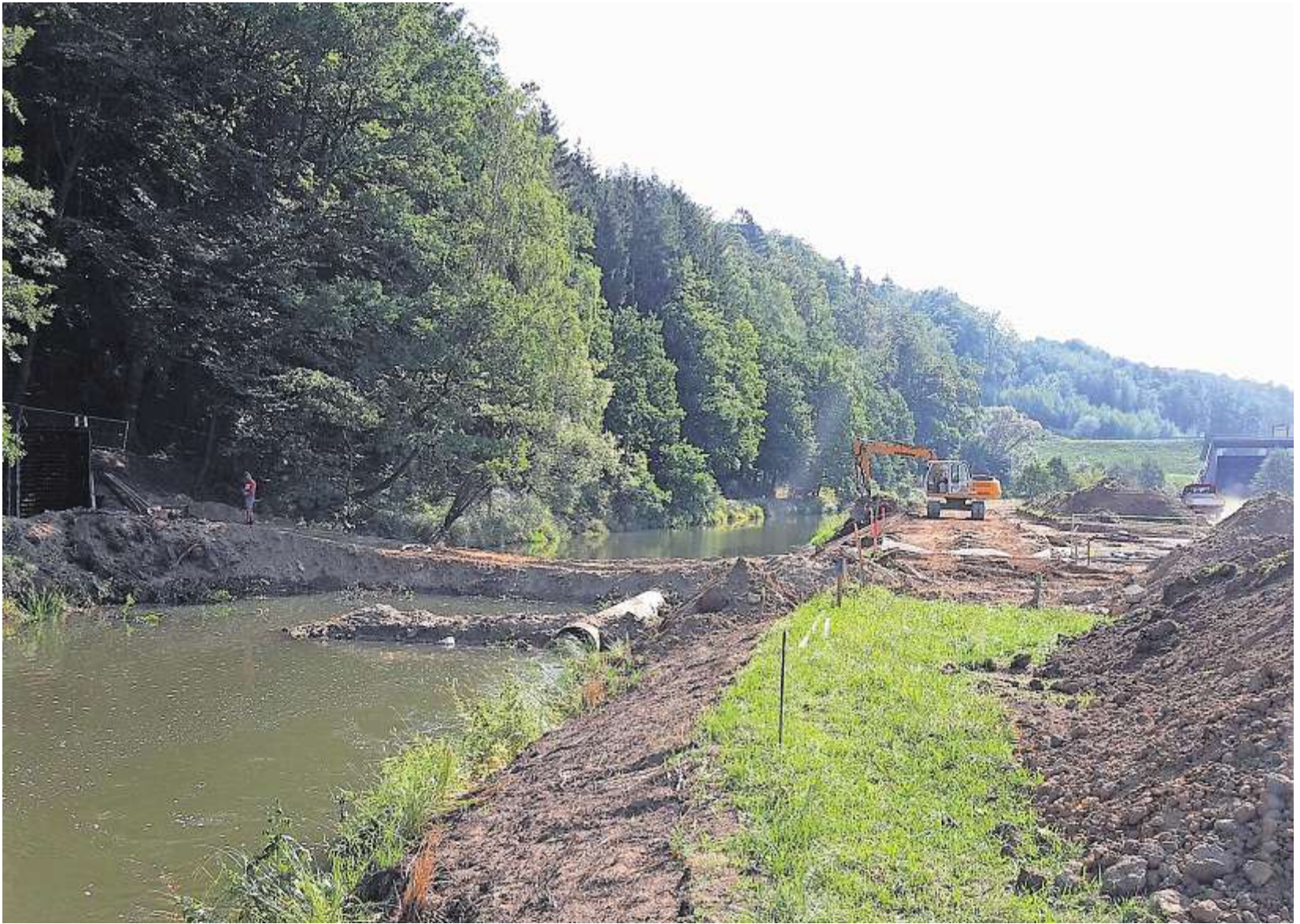
Vom Stauwerk am Drachensee aus ist die Baustelle gerade noch zu sehen. Hier entsteht ein Messpunkt, der öffentliche eingesehen werden kann. Fotos: wjf
